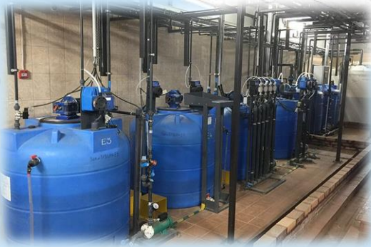
Помещение приготовления и корректировки химических растворов
